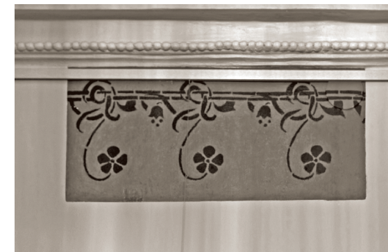
Фрагмент покраски стены до реставрации. Ноябрь 2022 г.
